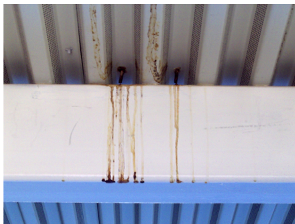
Korrosion an Bohrschrauben
